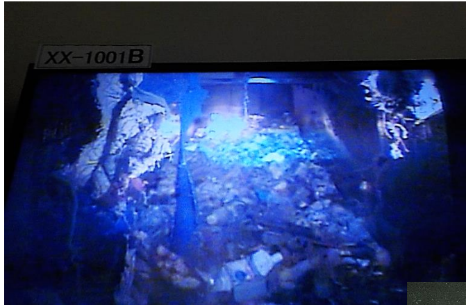
不燃ごみピットにて発火
